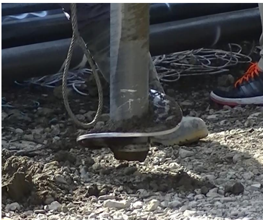
引抜き後の拡底翼（変形・損傷なし）
